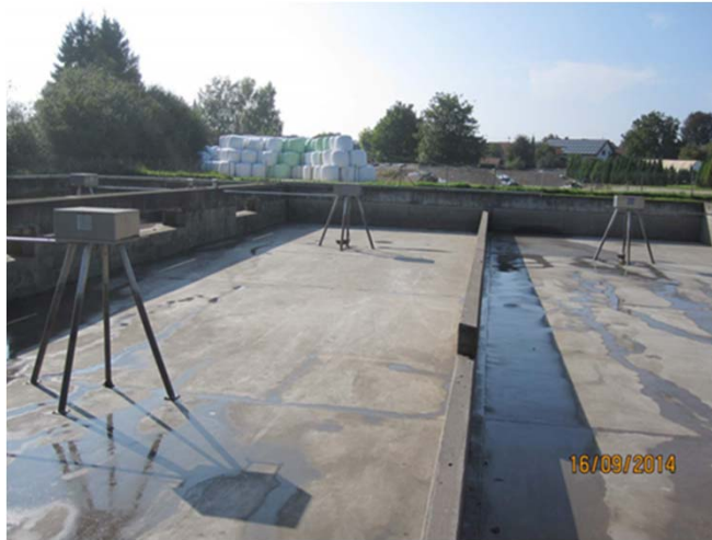
Becken nach manueller Nachreinigung
